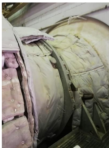
نمایی از عایق های حرارتی سمت کمپرسور
